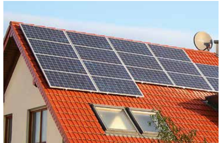
Photovoltaik-Module zur Erzeugung von Strom
