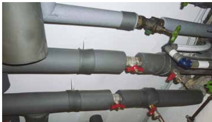
Gedämmte Heizungs- und Warmwasserrohre im Keller. Es fehlt hier die Dämmung der Armaturen.
