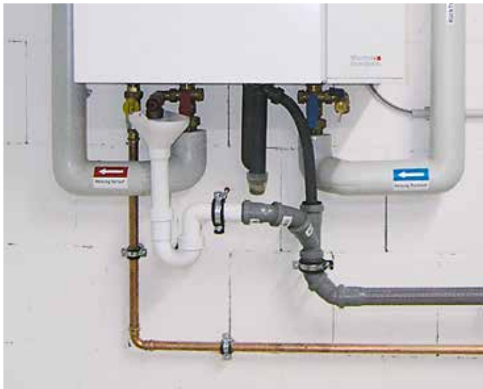
Kondensatablauf: Größere Mengen Kondenswasser sind ein Zeichen dafür, dass der Brennwert gut ausgenutzt wird.
