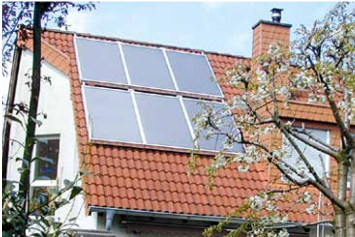
Solkollektoren (Flachkollektoren) zur Erwärmung von Wasser
