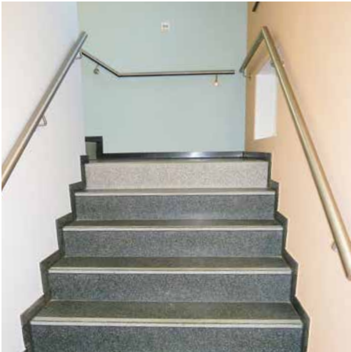
Vorbildlich ausgeführte Treppe in einem Seniorenwohnheim (Art und Anordnung der Handläufe, kontrastreiche Farbgestaltung)
