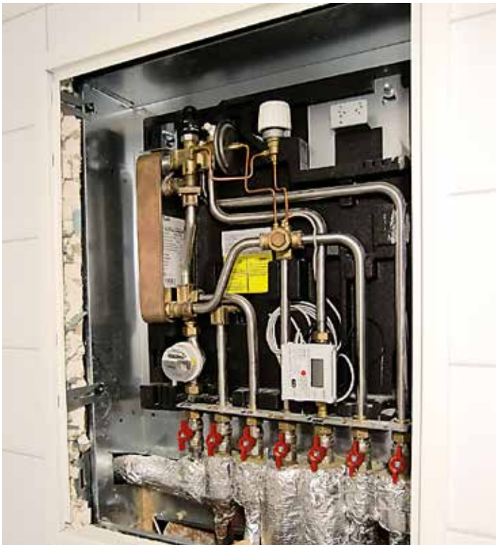
Frishwasserstation in der Wohnung eines Mehrfamilienhauses (hier ohne Abdeckung)
