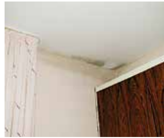
Schimmelbefall im oberen Eckbereich eines Zimmers
