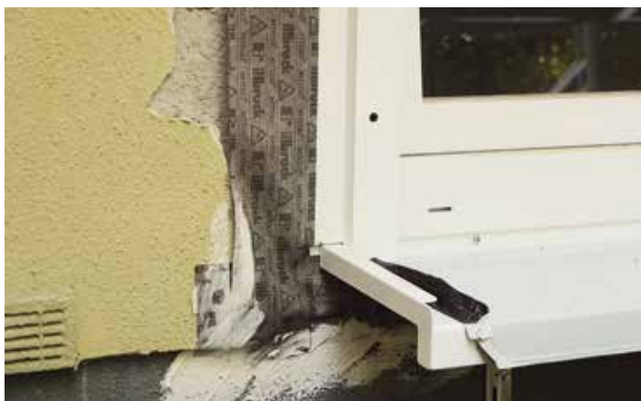
Nach außen versetztes, neues Fenster mit Dichtungsfolie. Hier wird anschließend eine Außenwanddämmung ergänzt.
