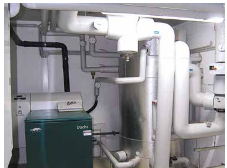
BHKW mit Wasserspeicher in einem Mehrfamilienhaus
