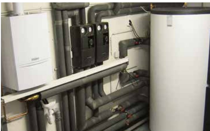
Zentrale Warmwasserbereitung mit Wasserspeicher
