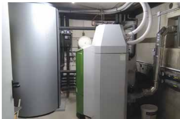
Heizkessel einer Holzpellet-Zentralheizung im Mehrfamilienhaus
