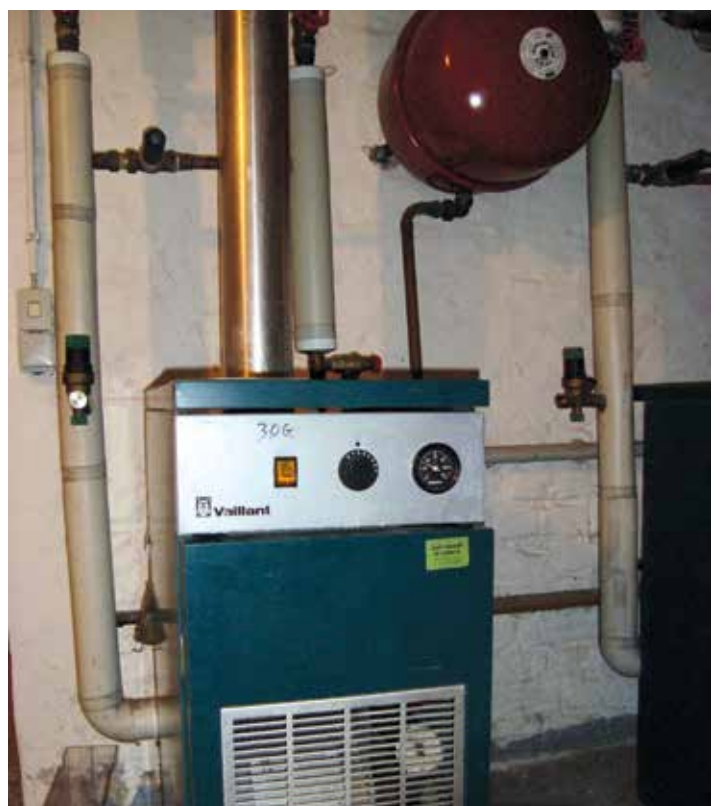
Alte Heizkessel – dieser ist von 1980 – verschwenden Energie. Außerdem belasten sie die Umwelt und Ihren Geldbeutel.
