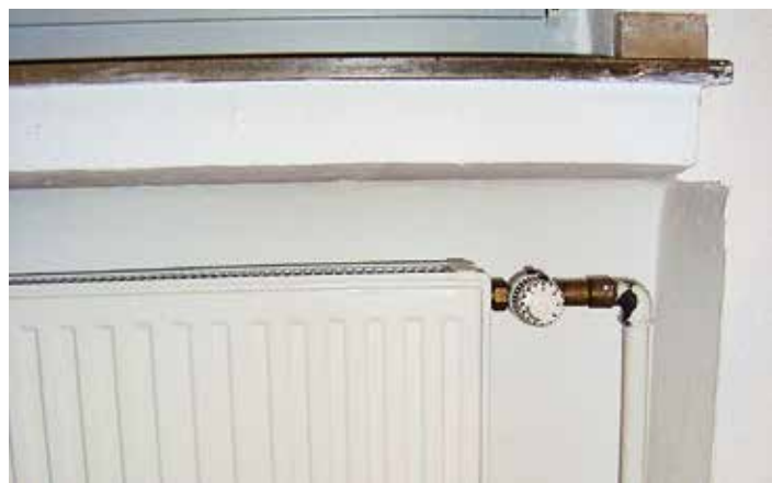
Häufig befinden sich Heizkörper in Wandnischen.
